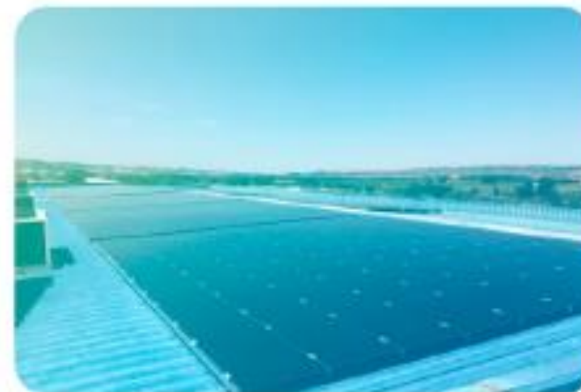
Instalación Almacén GRECO (Toledo)
