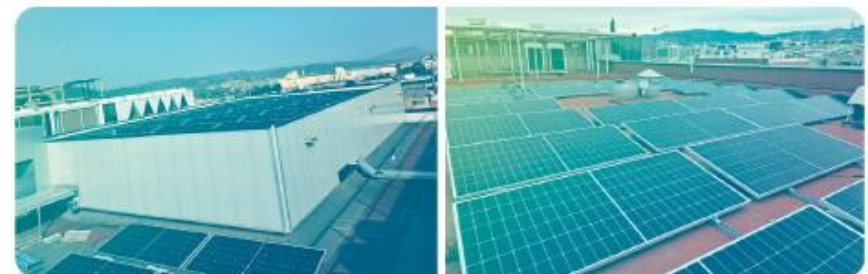
Placas fotovoltaicas fachada y terrado Sant Joan Despí
